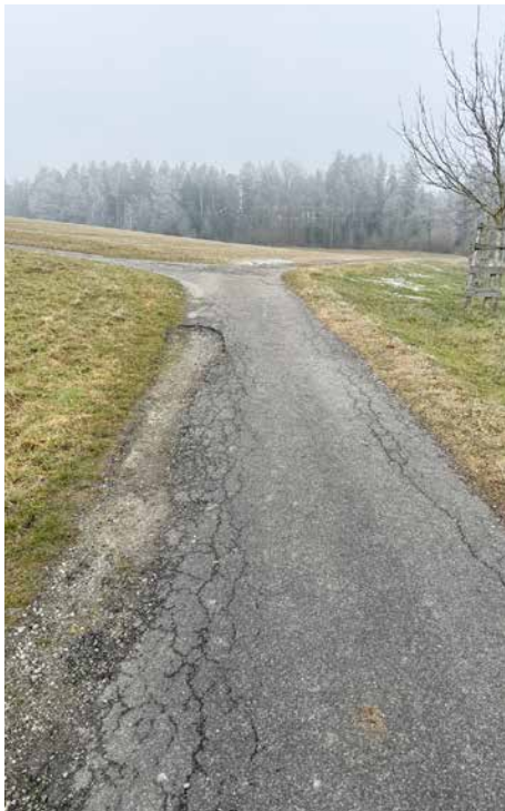
Die Berghaldenstrasse vor der Sanierung. Der alte Schwarzbelag wies zahlreiche Schäden und Schlaglöcher auf, weshalb eine Erneuerung notwendig wurde.
