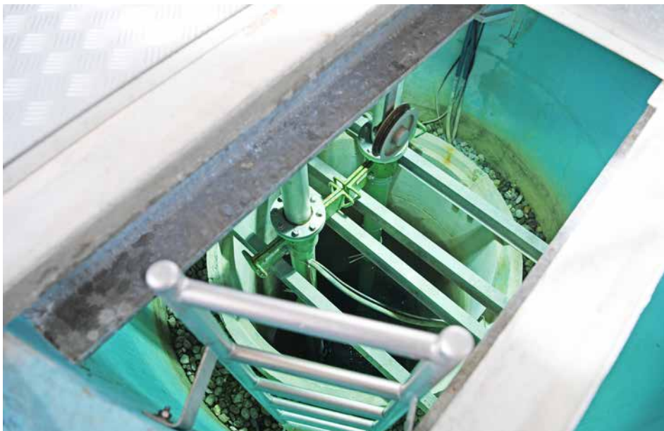
Blick in den Grundwasserbrunnen von Elsau
